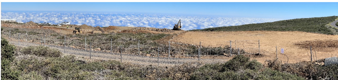
Panorámica LST3, donde se aprecia la plataforma auxiliar el acopio de pétreos ya extendidos y mayor elevación de la plataforma. A la derecha se observa la formación de la plataforma auxiliar del LST4, con la escollera ya realizada y cubierta de los codesos para su descomposición.
