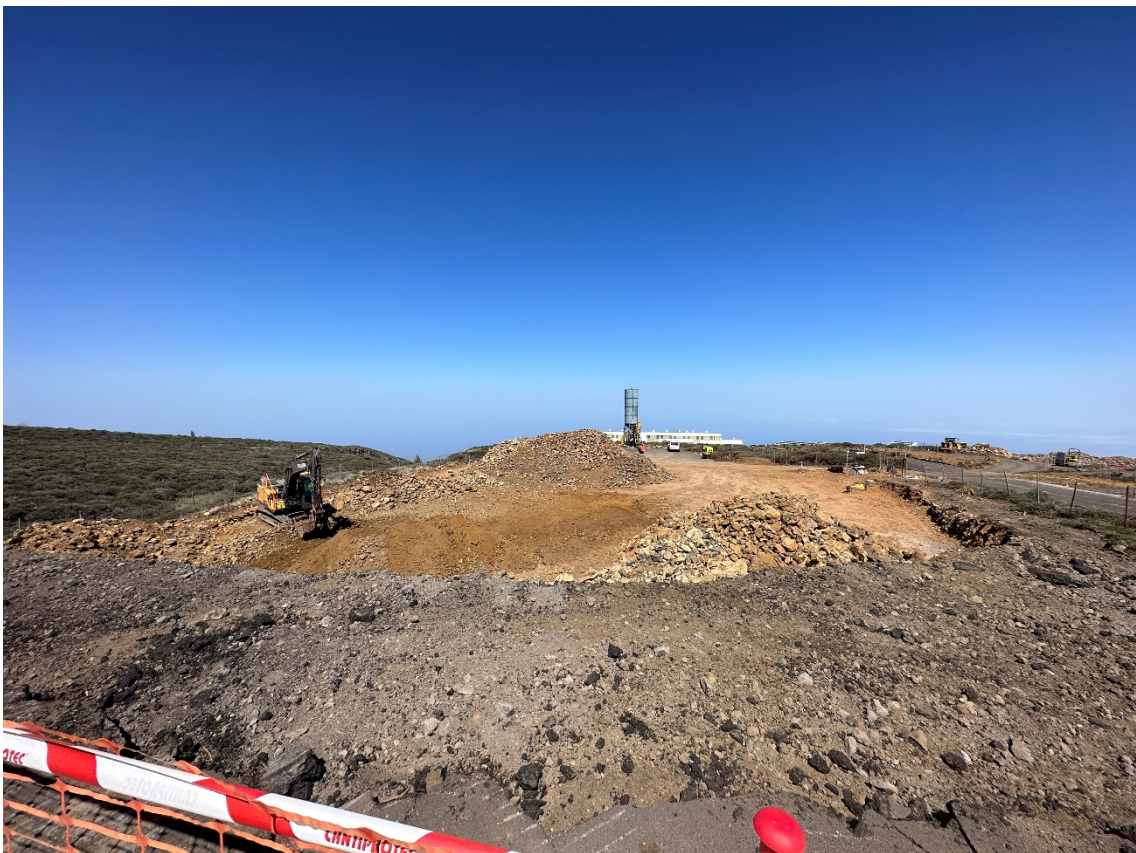
Desmante y clasificación LST2, para posterior traslado de material hasta el LST3
